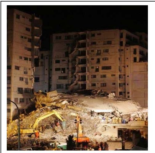
倒壊したアパート
